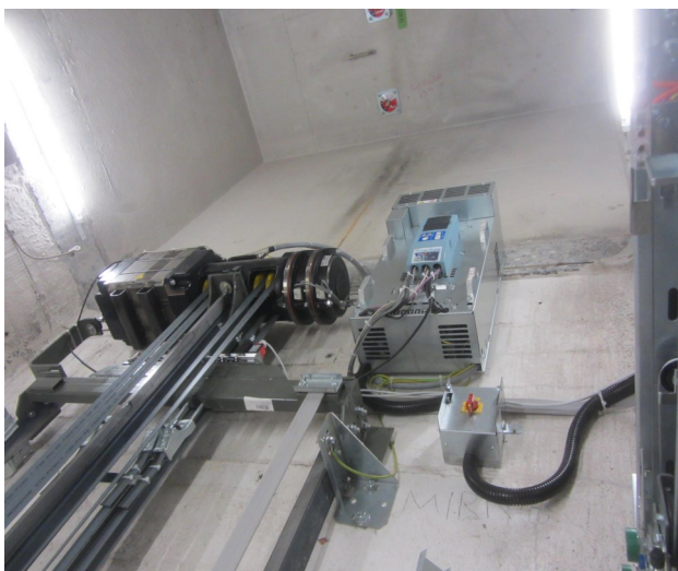
Abb. 2: Neuer Liftantrieb mit Steuerung im Schachtkopf nach Renovation
