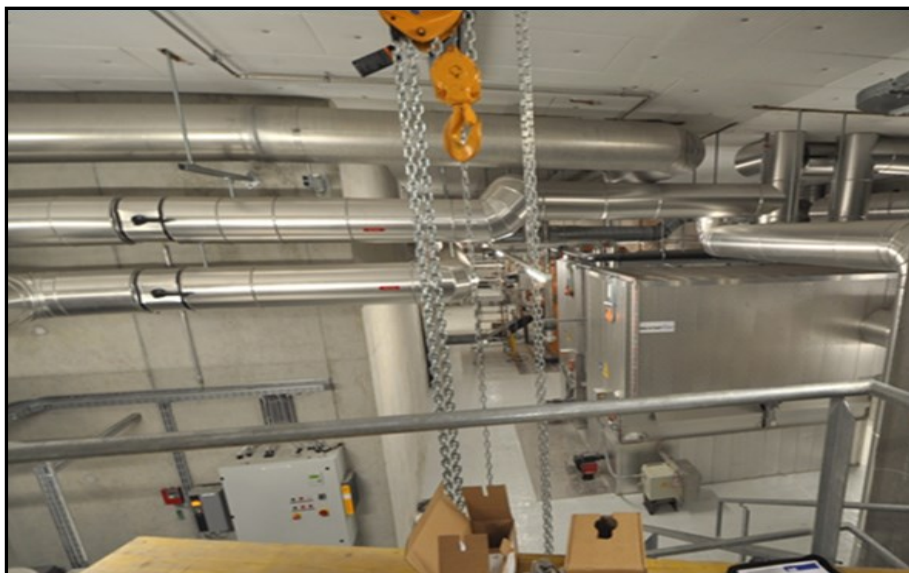
Blick in eine Heizzentrale
