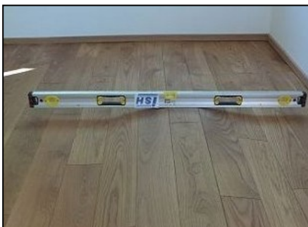
Folgeschaden: Aufgeworfenes Parkett in der Folge eines Wasserschadens
