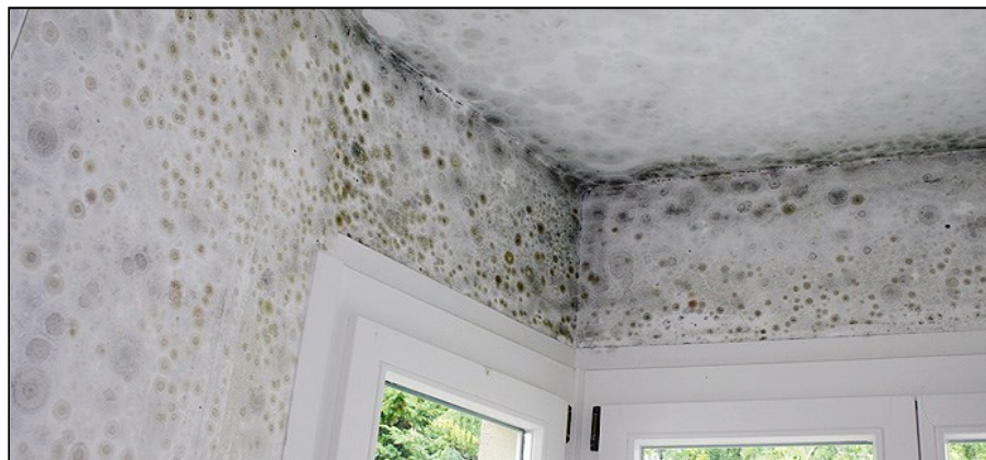
Bild: Schimmelpilzbildung in Aussenecke
