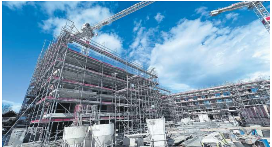
Alle Wohnhäuser des «Golf-Parks» sind nun aufgerichtet. Die ersten Wohnungen können im Frühling 2027 bezogen werden. BILDER: RAN
